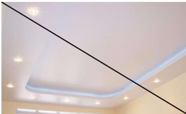
Плохо Многоуровневые гипсокартонные конструкции
